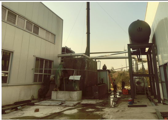
原有项目水膜除尘设施
