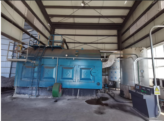
原有项目锅炉
