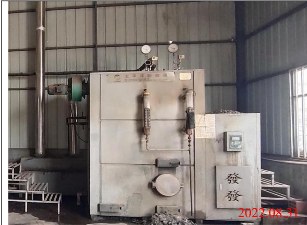
蒸汽发生器（已建 2 台 0.98t/h）
