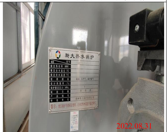
2.8MW 燃气热水锅炉（未投入使用）
