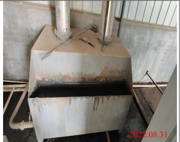
蒸汽发生器烟气现状除尘设施
